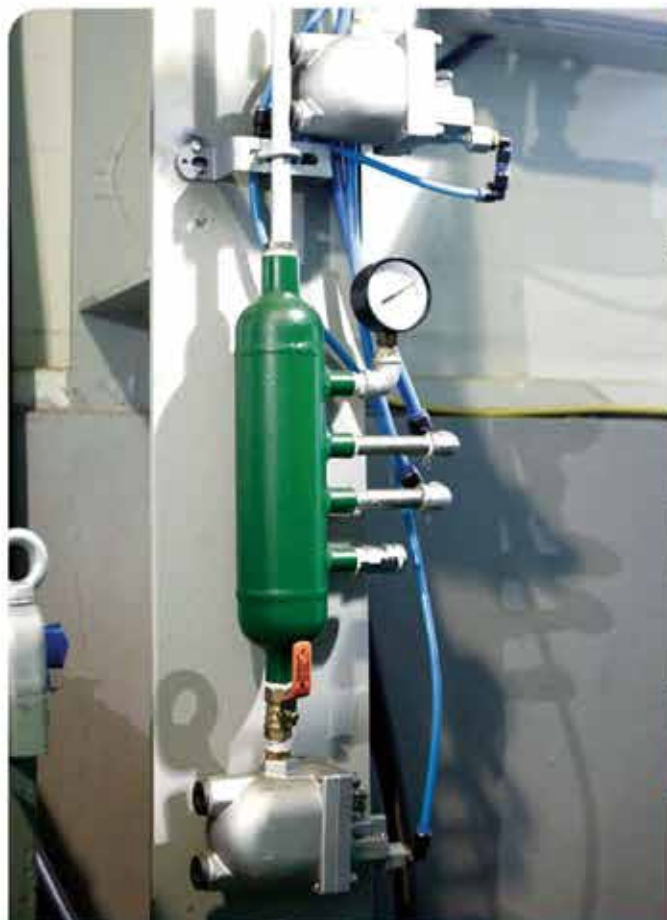
▲ 配管ラインに設置の例
