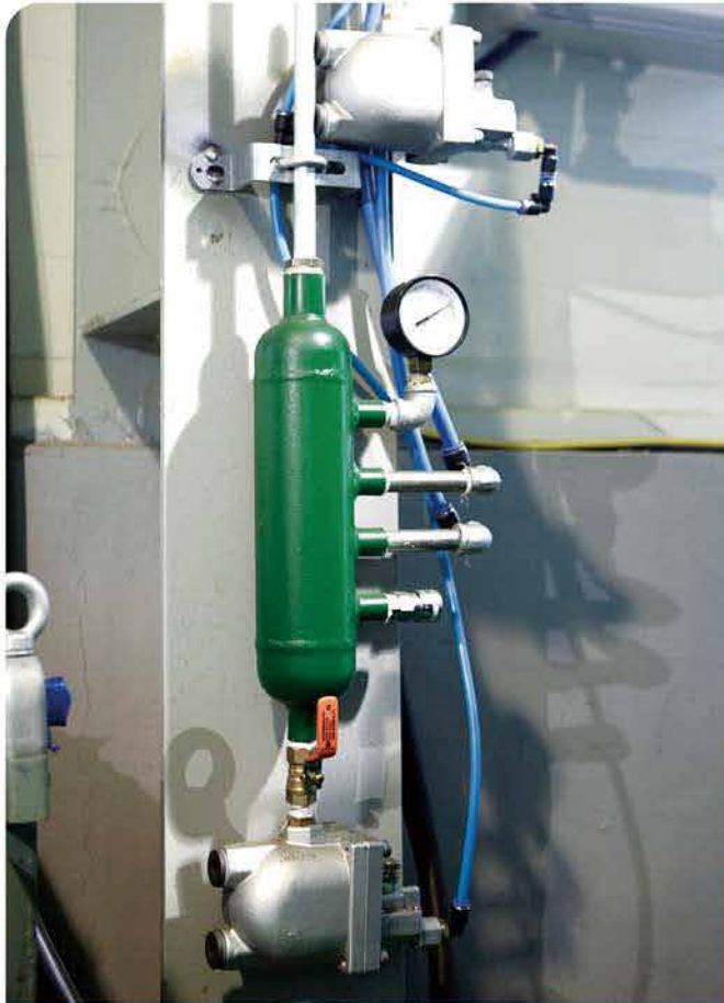
▲ 배관라인에 설치된 예
